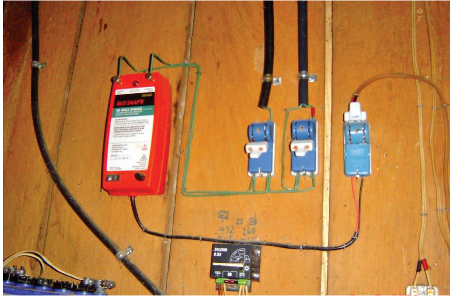
Foto 11. Central de electrificación con pulsador, batería y otros Crédito: Danilo Pezo, CATIE
