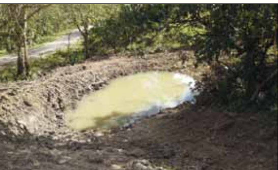
Una aguada construida dentro de un arroyo, lo cual aumenta el riesgo de desbordamiento.
