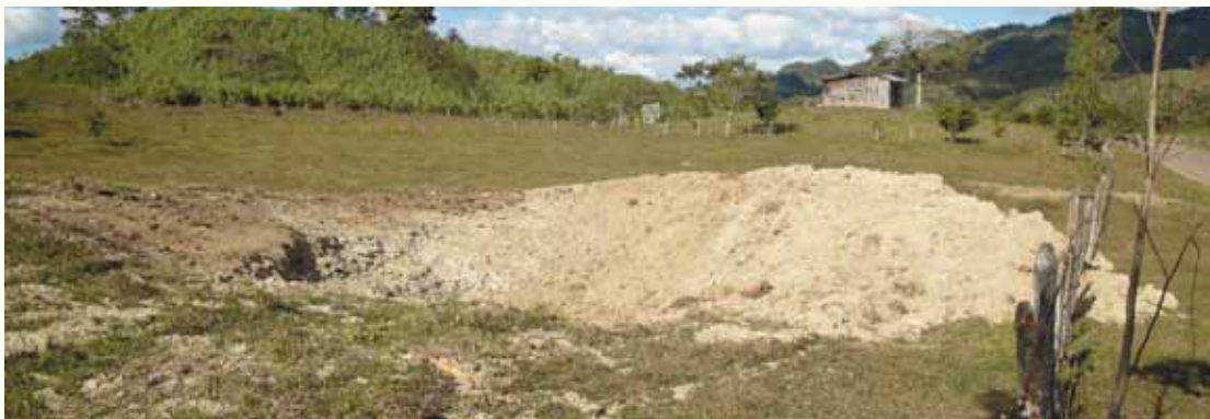
Una aguada recién construida con mala colocación de la tierra excavada (no se formaron taludes).
