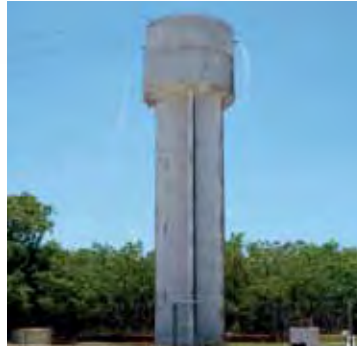
Tanque de almacenamiento de agua de San Felipe Foto: Ricardo López, Investigador IMTA
