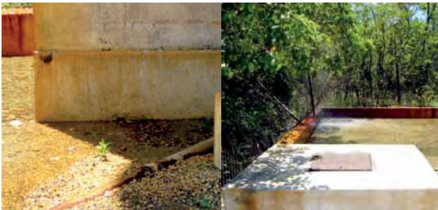
Instalaciones deterioradas del tanque de almacenamiento de agua potable de San Felipe Foto: Ricardo López, Investigador IMTA
