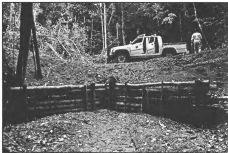
Foto 4. Filtro protegido por una pared de madera, junto a un sitio por donde corre agua durante la estación lluviosa.
