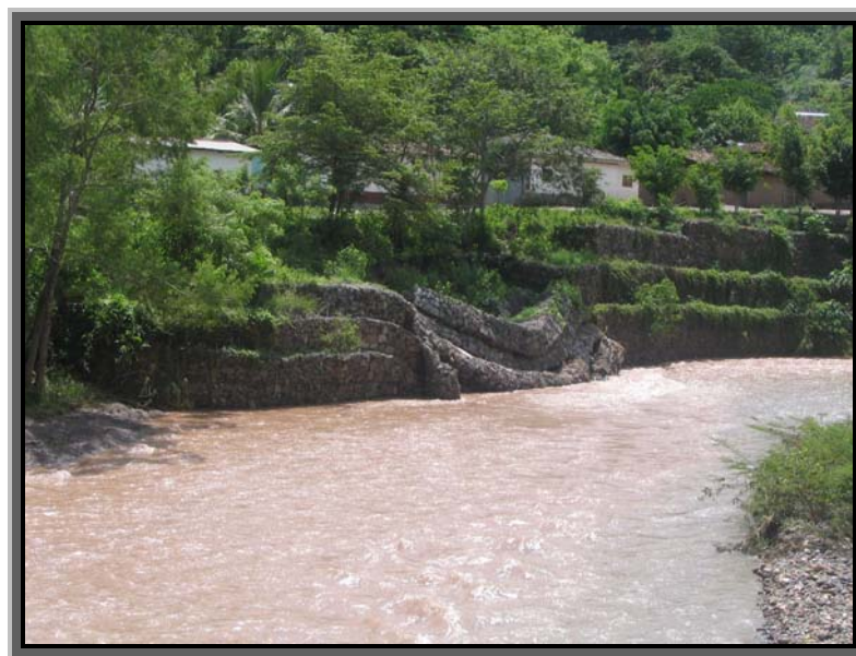
Figura 36. Gaviones en mal estado comunidad de Río Negro.
