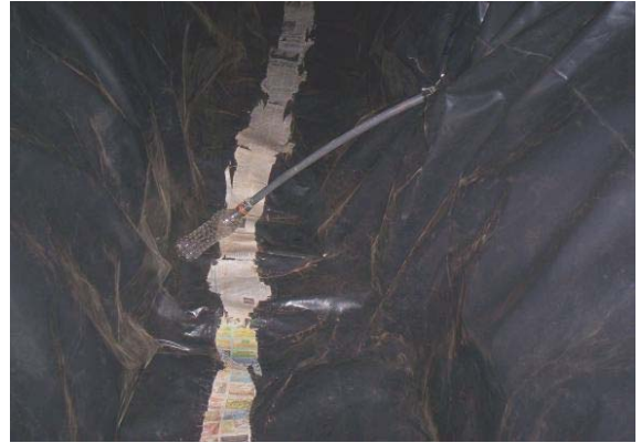
Figura 67. Área de descarga y filtro
