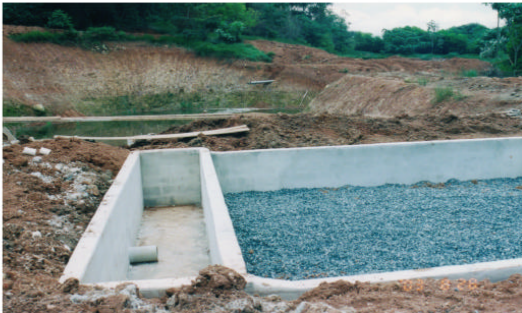
Decantador a base de grava
