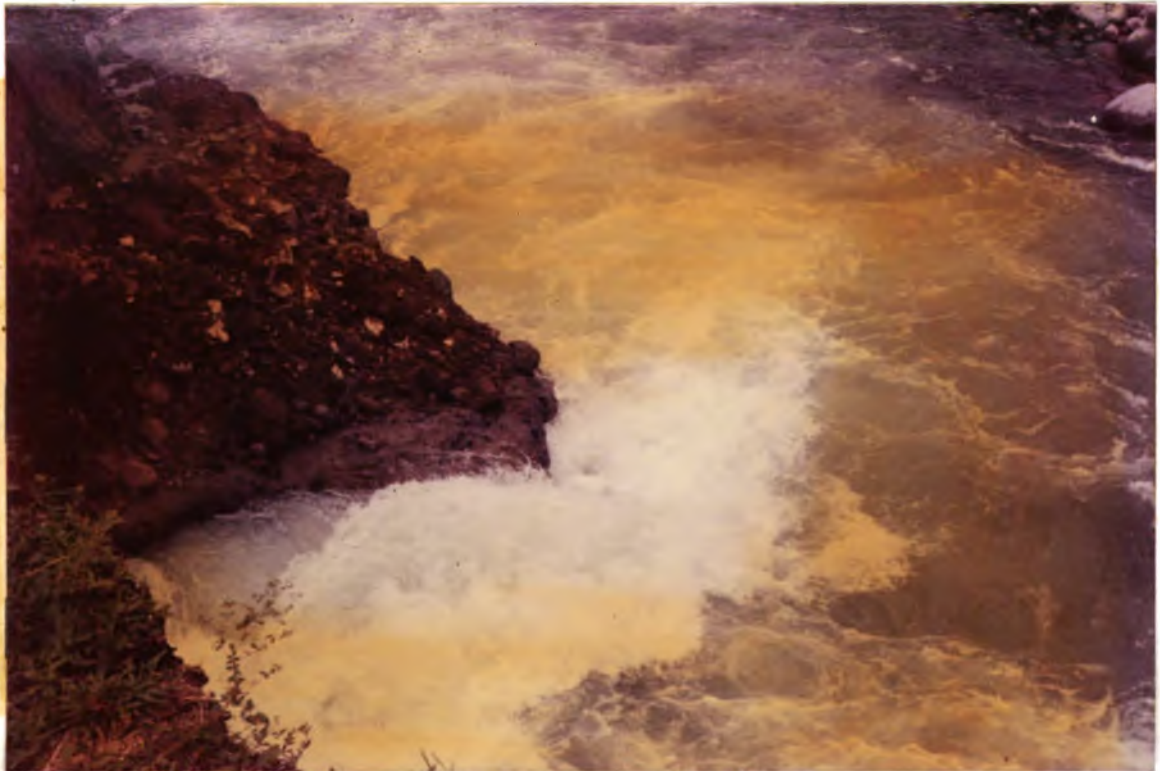
#6 Close-up de la socavación margen izquierda; aguas arriba puente La Guinea
