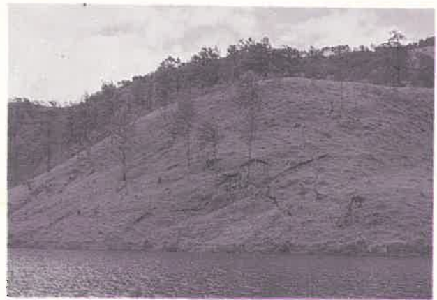
Deforestación y deslizamiento en márgenes del embalse.
