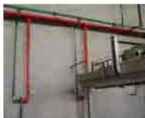
Tuberías de distribución de vapor aisladas.
