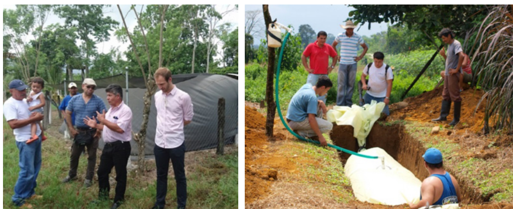
Figura 13. Biodigestores familiares de bajo y medio costo
