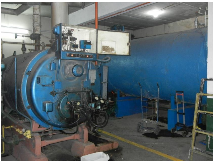
Figura 25. Cuarto de máquinas
