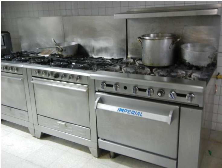
Figura 28. Área de cocina (estufas)
