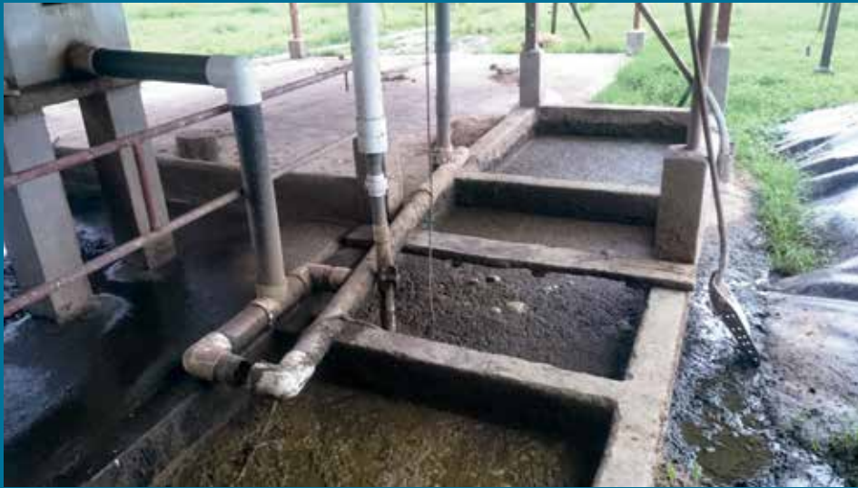
Separador de sólidos por densidad de tres fases.
