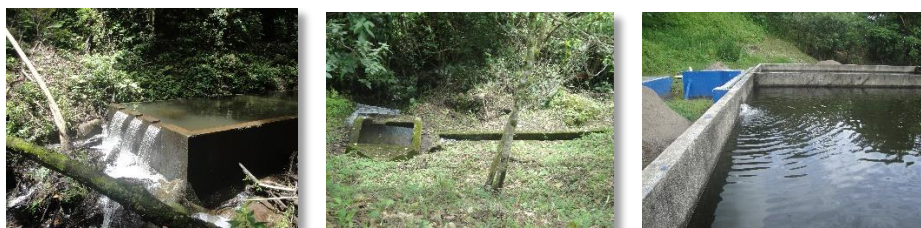
Figura 3. Sistema de captación y purificación de agua en la comunidad Isla de Peñas Blancas
