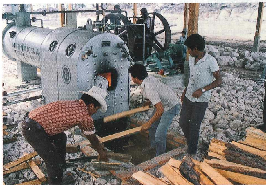
Los campesinos mismos operan la maquinaria (locomóvil) de producción de energía eléctrica. Utilizan como combustible desechos de madera de la industria. (Foto: B. Carías).
