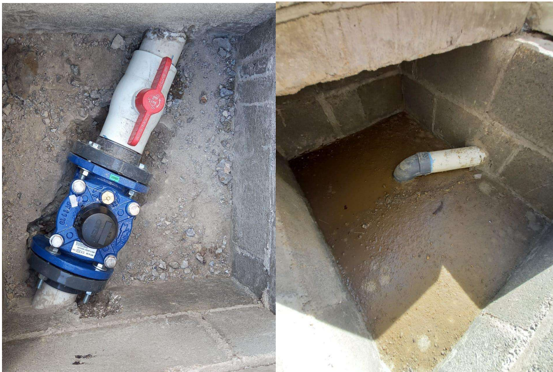
Punto de ingreso del agua al pozo de recarga después de pasar por el contador
