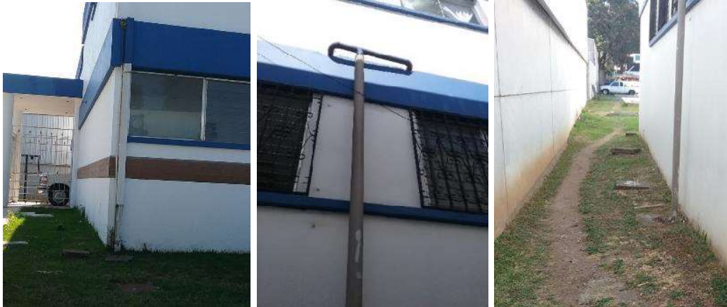
Detalle de tuberías de bajantes hacia sistema de desfogue dirigido a los pozos de infiltración de agua pluvial
