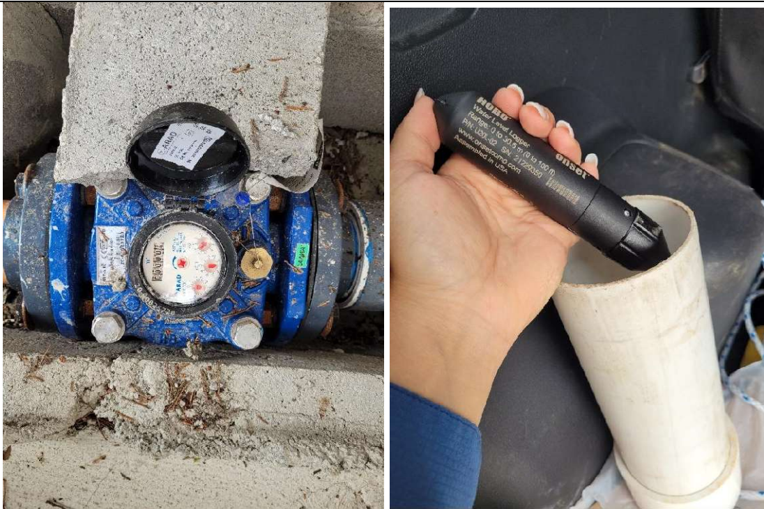
Contador instalado en el pozo del canal pozo_MIX-01 y muestra del tipo de datalogger instalado en pozo_MIX-01 y pozo_MIX-02 que opera para un rango de 0 a 30.6 m de profundidad.
