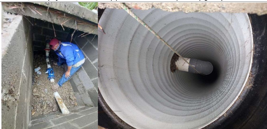
Detalle de área de contador e interior uno de los pozos secos de infiltración con encamisado de PVC
