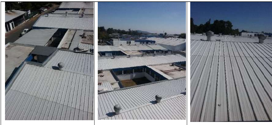
Vistas panorámicas de los techos de láminas y de terraza en el proyecto, cuya agua pluvial es dirigida a pozos de infiltración.
