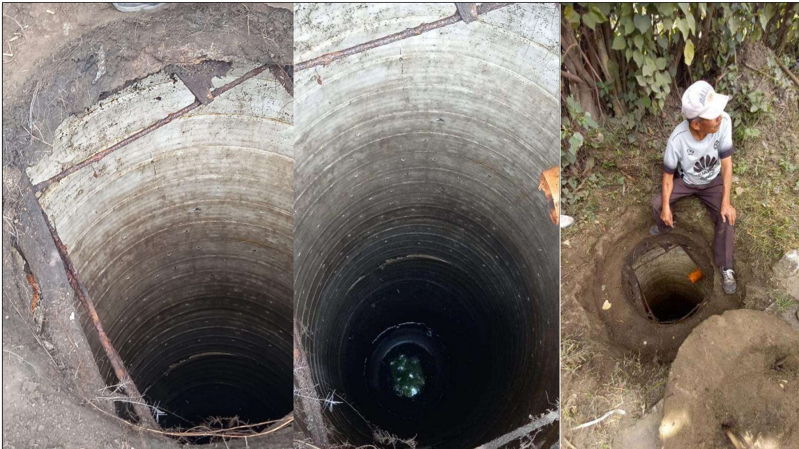
Detalle interno y externo de uno de los pozos del municipio hecho para infiltración de aguas pluviales, con su encamisado en PVC perforado
