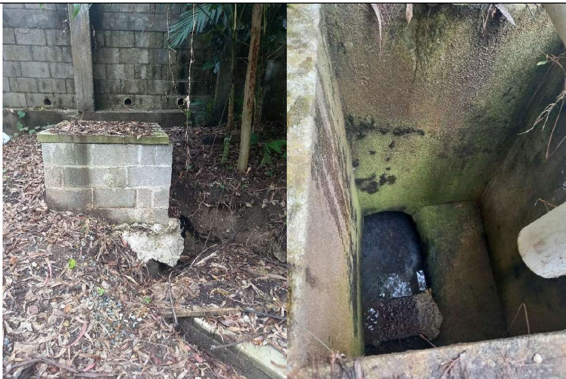
Caja protectora del pozo y caja unificadora de aguas, previo al ingreso de agua al pozo.
