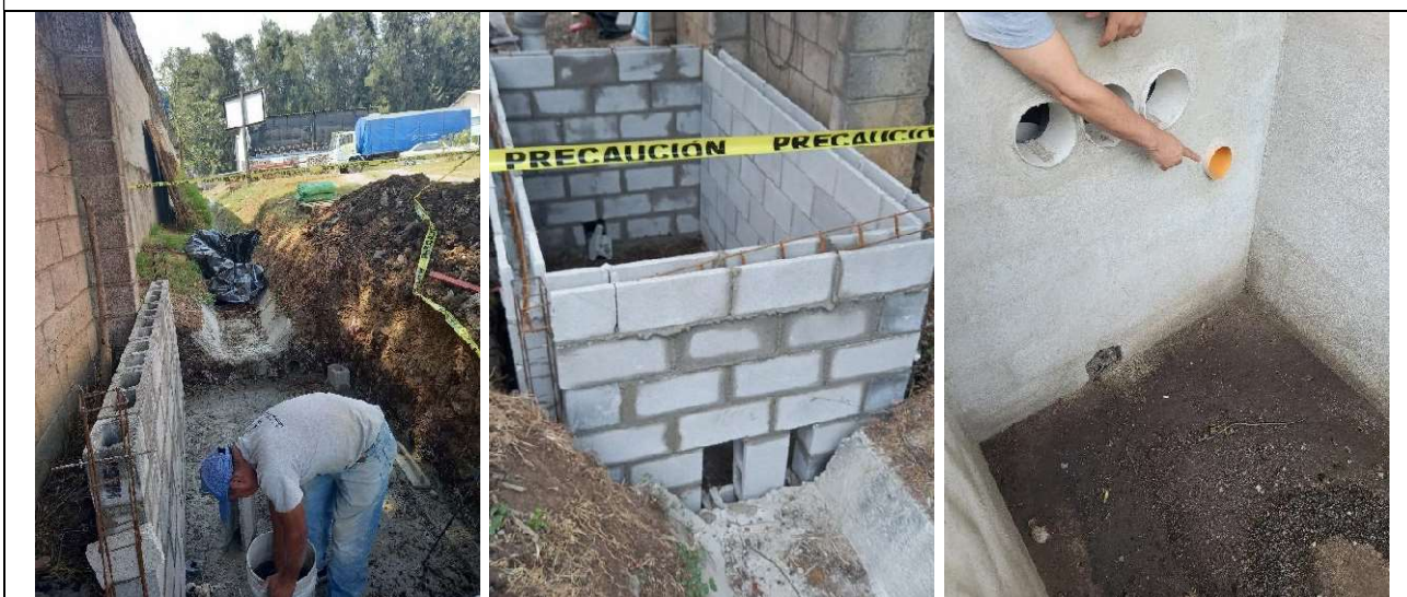
Mejoras realizadas con caja de sedimentación en canal de aguas pluviales e instalación de contador. Este diseño deberá sufrir modificaciones, pues la posición del contador no es la apropiada, como consecuencia el agua no pasa marcando el volumen.
