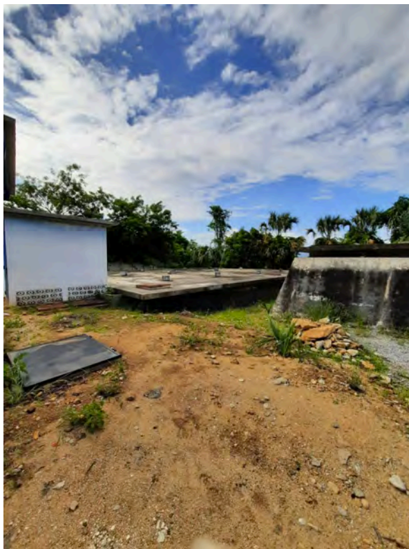
Fotografía 5 – Tanques municipales de distribución del agua domiciliar
