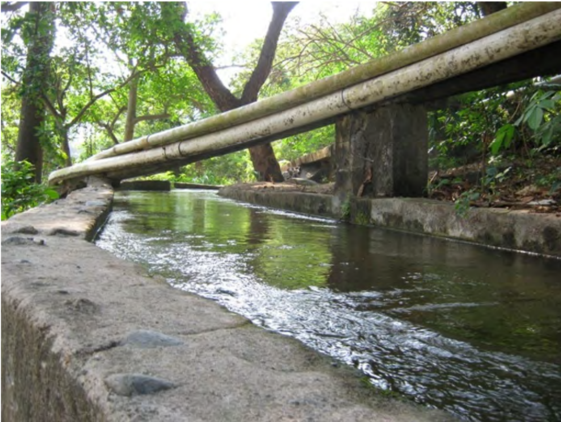
Fotografía 2 – Vista de las tuberías de agua para abastecimiento domiciliar y una toma de riego
