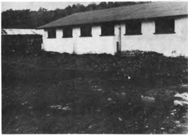
Vista parcial del inicio de las obras de remodelación llevadas a cabo en el edificio principal de la Estación Experimental de Producción Animal.
