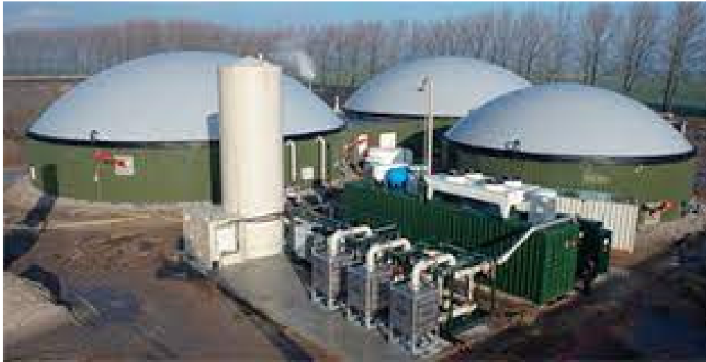
Figura 5.5. Vista de una planta eléctrica industrial de producción de biogás Foto: Michael Lopez - Herrera
