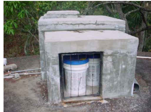
Tratamiento en el tanque San Pedrito
