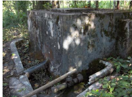
Tanque rompecarga San Cristóbal
