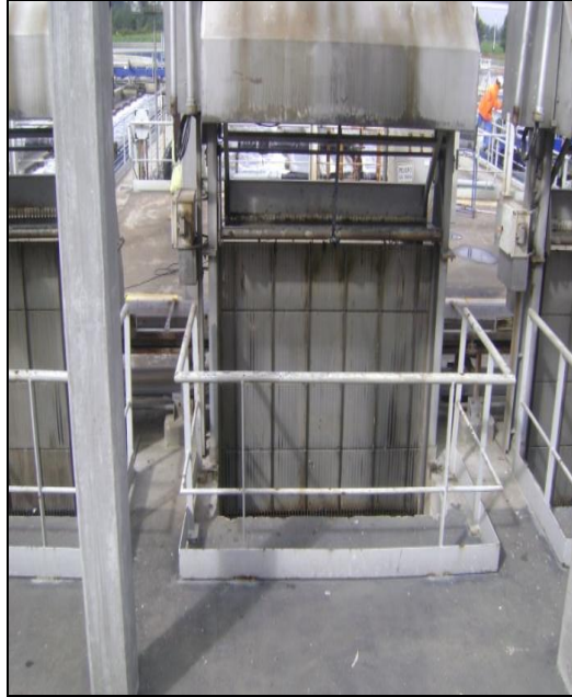
Figura 7. Estación de muestreo denominada como PTAR El Salitre.
