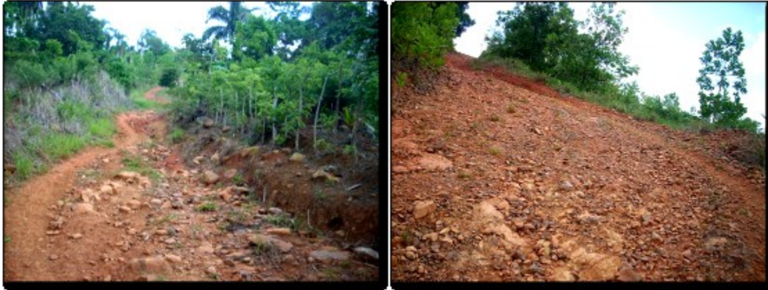
Figura 27 Carretera que conduce a La Llanada en la sección de Chacuey Maldonado, DM Zambrana Abajo.
