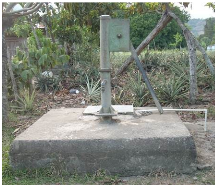
Figura 26 Como parte de los proyectos impulsados por ENDA-Caribe se instalaron pozos tubulares.
