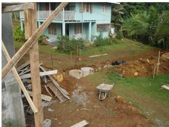
Foto 4. Fosas sépticas construidos con materiales inadecuados en Moravia
