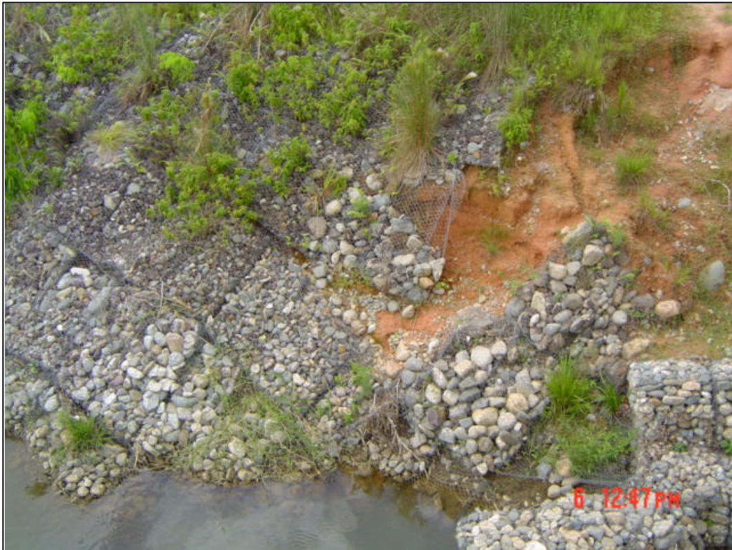
Figura 7. Gaviones en la parte media del Río Cuero destruido por las crecidas.
