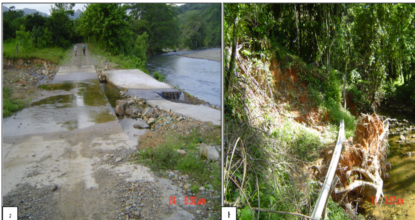
Figura 5. Puente que comunica a las comunidades de la parte alta del Río Cuero con la carretera pavimentada principal, b) vulnerabilidad del sistema de acueducto de la comunidad de El Naranjal, La Masica.
