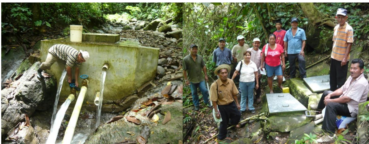
Figura 22. Obra en cauce de la toma de agua en el río Sofrito y toma en nacientes u ojos de agua.
