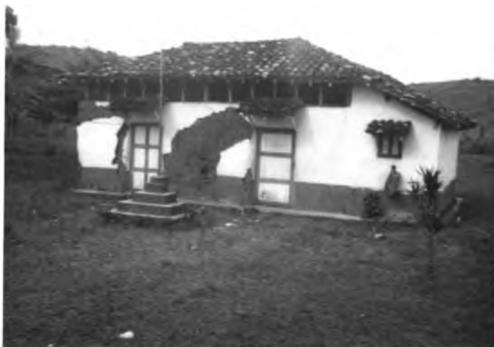
FIGURA 9. Escuela de Río Viejo del Solar, en mal estado.
