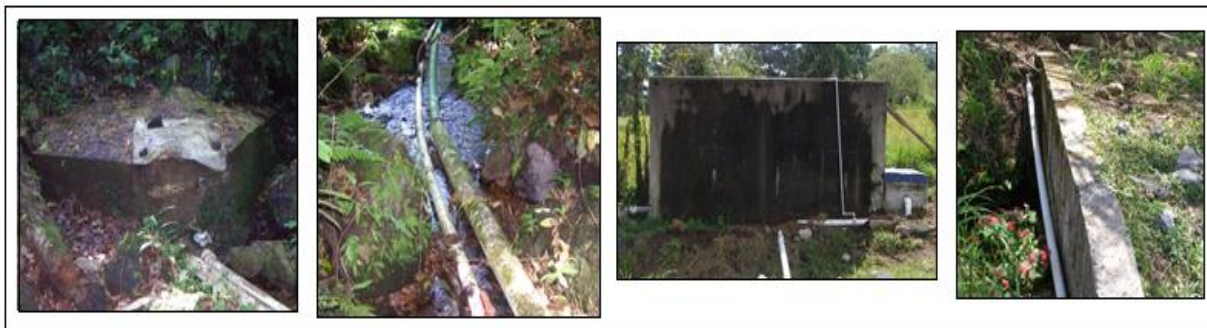
Figura 10. Principales estructuras del acueducto de Buenos Aires. De izquierda a derecha: obra de captación del manantial, tubos madre, tanque de almacenamiento y red domiciliaria
