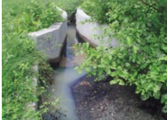
Acumulación de desechos en entrada de canal Parshall.
