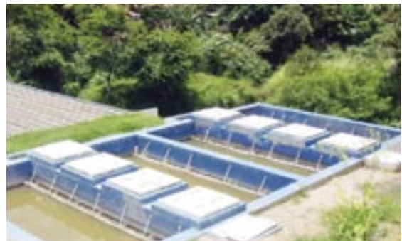
Dos tanques anaerobios de flujo ascendente, que sustituyen a un sedimentador primario, Ciudad Futura, El Salvador.
