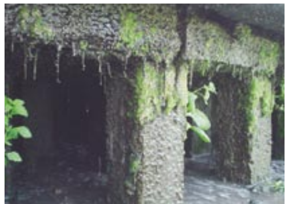
Acumulación de desechos en salida de filtro.
