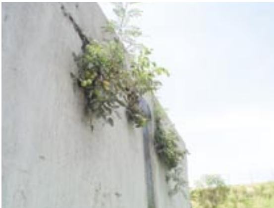
Pared fracturada en filtro.
