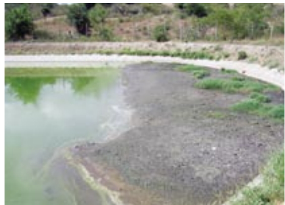
Acumulación de lodos y vegetación en laguna.
