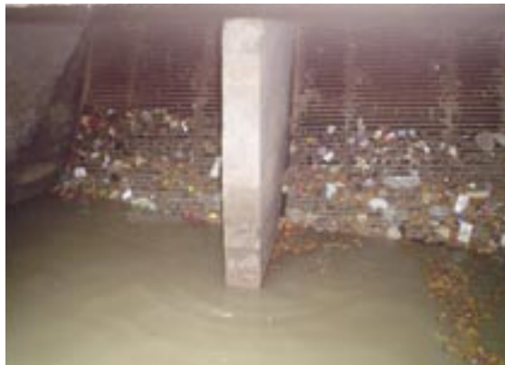
Acumulación de desechos en rejillas.
