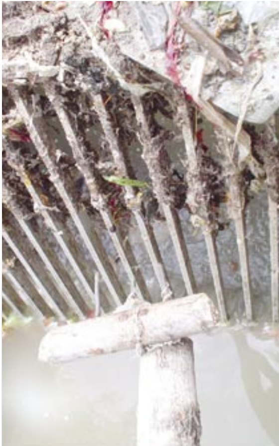
Acumulación de desechos en rejillas.
