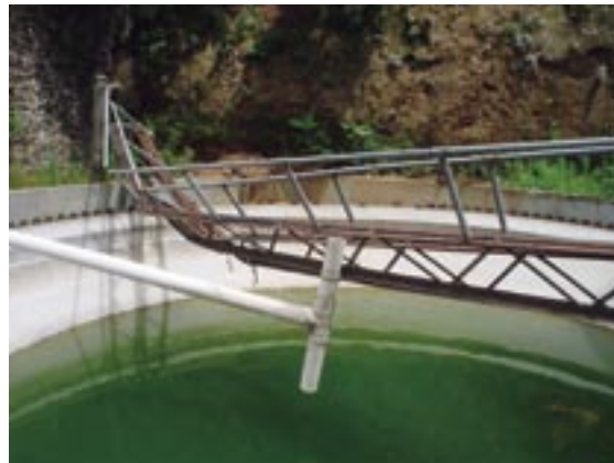
Pasarela en sedimentador.
