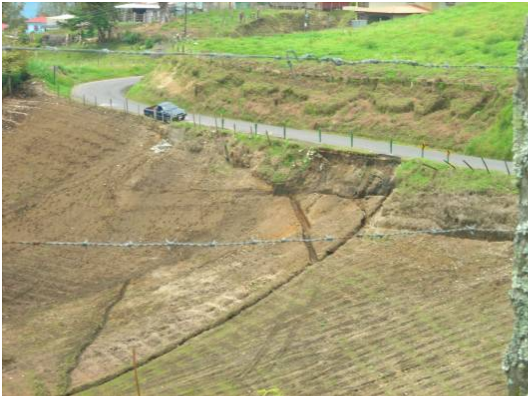
Foto13: Deslizamiento en la cuenca del río Birrís, en la comunidad de Pacayas.
