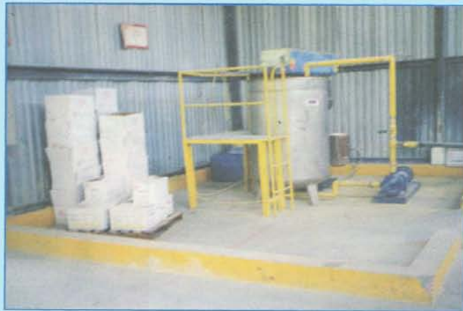
Medidas de seguridad para la contención de derrames, aplicada en la industria.
