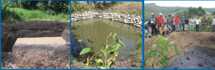
Lagunetas de captación de agua con doble propósito: almacenamiento y captación para infiltrar y alimentar las fuentes de agua
