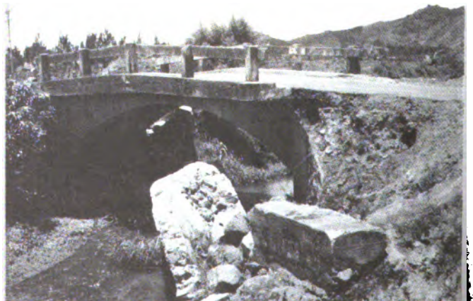
Río Purires: Puente afectado.
